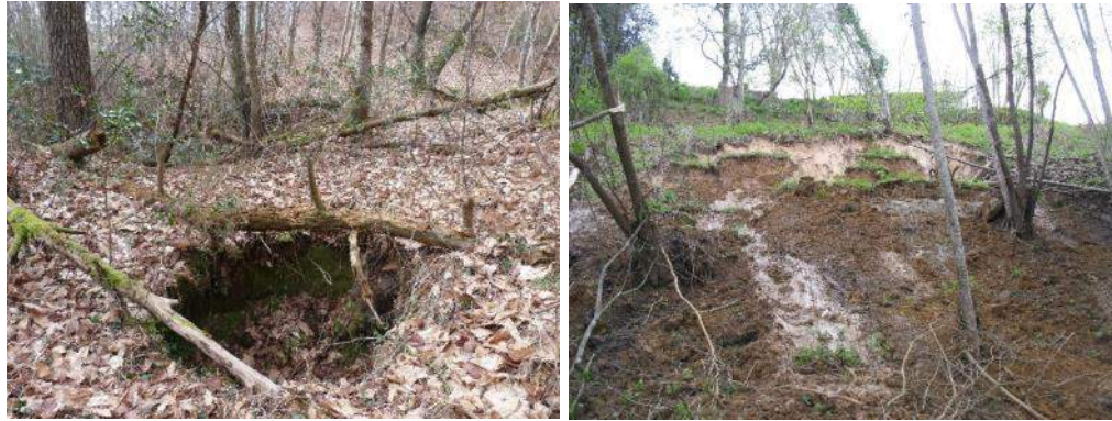
Illustration du phénomène d'effondrement Conséquences de l'érosion
